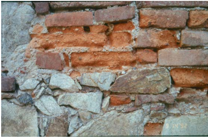
Abbildung 2: Mauerwerk mit Bruchsteinbereichen.
