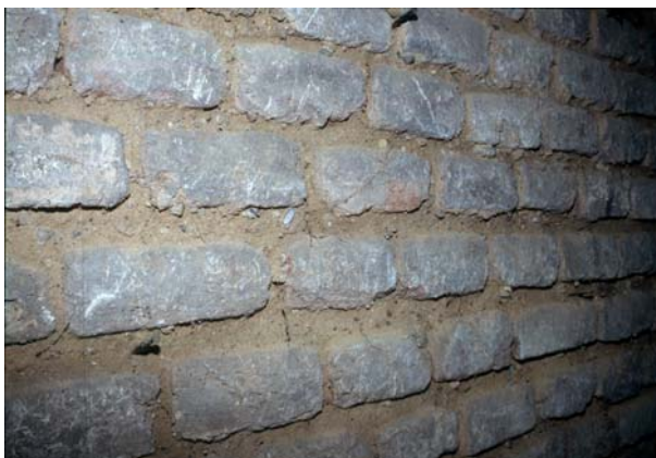
Abbildung 3: Mauerwerk mit Bindemittelauswaschung in den Mörtelfugen.
